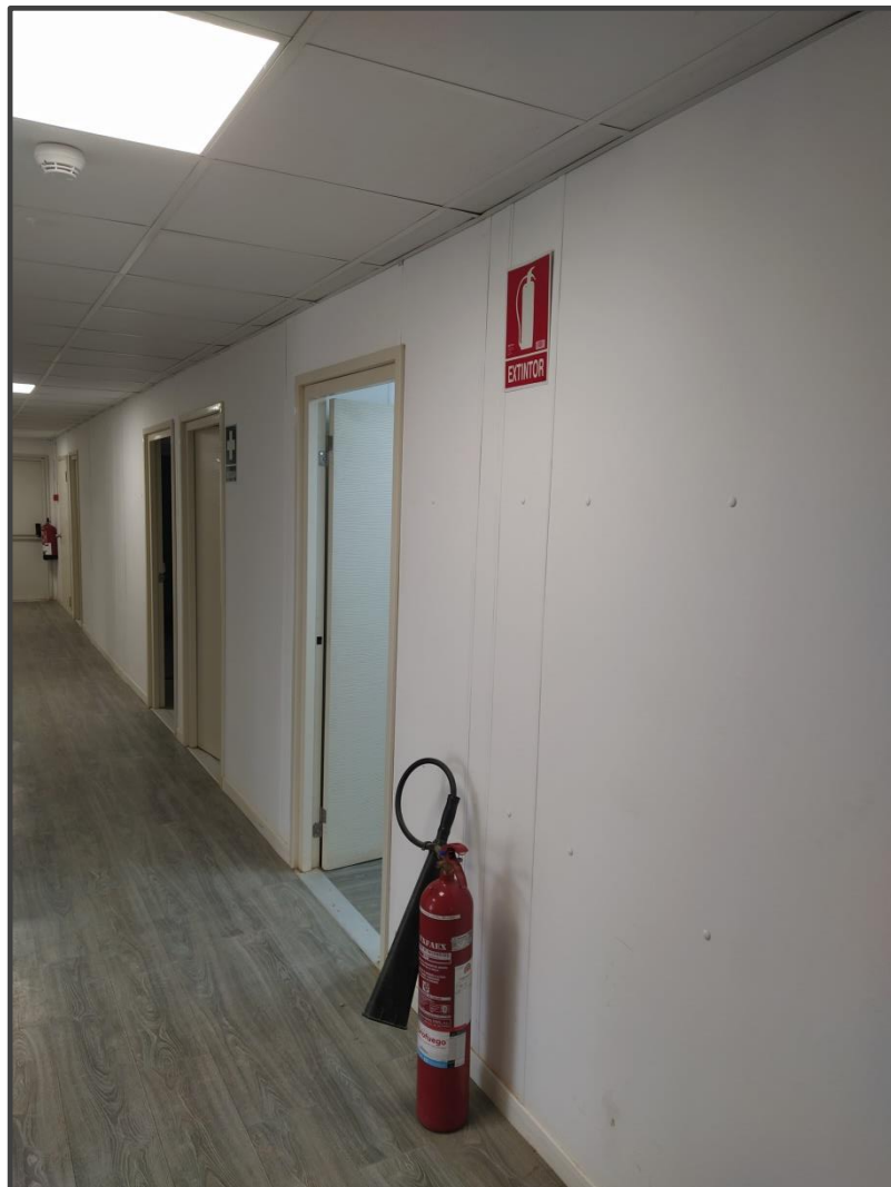
Fotografía 7. Extintores en edificio de control.
